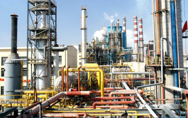
石化设备检测
